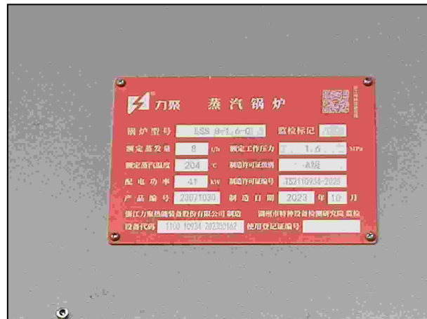
8t/h 燃气锅炉铭牌
